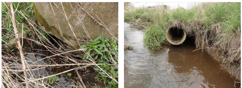
Figur 35 Tv. Vandløbet løber i en brønd gennem et hul i en af brøndringenes sider. Th. Røret er på den nederste del faldet sammen og er ved udløbet i Hagensmølle Bæk ikke vandførende.
