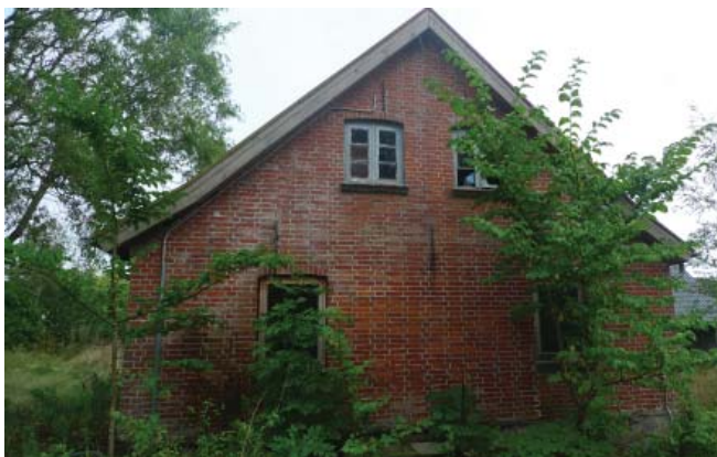
Forfalden ejendom ved indkørslen til Selde, der ønskes nedrevet.
