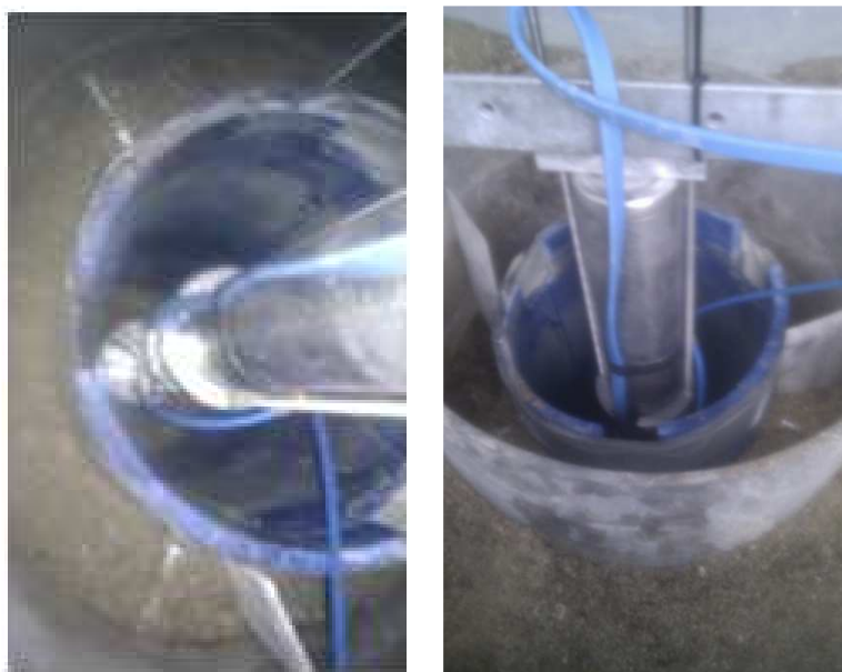
Figur 3.1.5. Sirene med 2 lydhoveder monteret i sandbeholder
