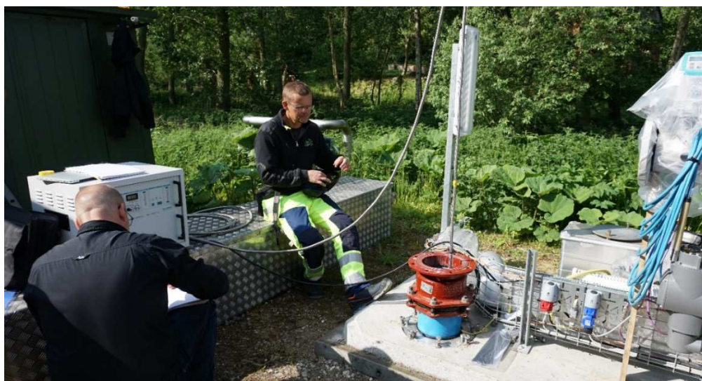
Figur 6.2.2 Assermølle Kildeplads, ultralydssonden monteret i boringen
