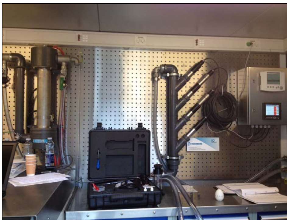
Foto nr. 10. Procesmålingsudstyr. I midten ses manifold med elektroder og til højre ses datalogger
