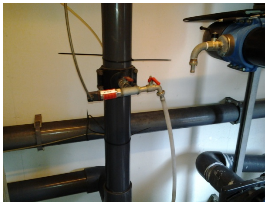
Foto nr. 13. Tilkobning til afværgeanlæg Kirke Værløsevej 53
