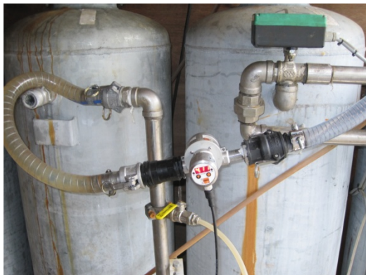
Foto nr. 12. Tilslutning til afværgeanlæg. Flowmåler til registrering af flow ses i midten af billedet
