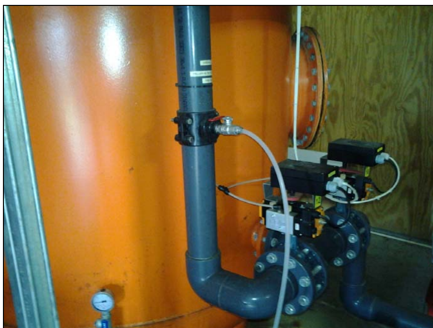
Foto nr. 15. Tilslutning til afværgeanlæg Søborg Hovedgade 31
