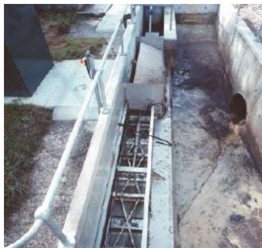
Overløbsbygværk med HydroScreen spalterist
