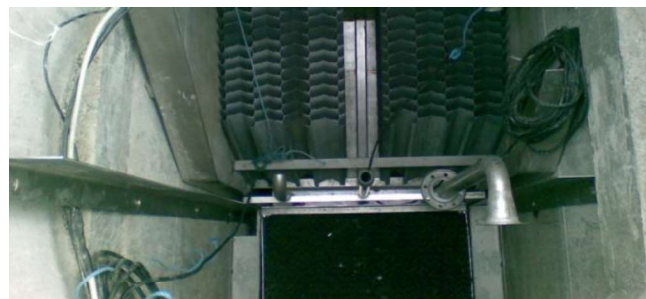
HydroSeparator etableret på Sluseholmen, København
