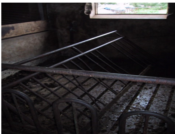
Figur 5. Skillevæggen er faldet ned med risiko for, at dyrene kan få benene i klemme og komme til skade.
